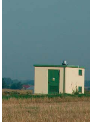
stacja transformatorowa 15/0,4 kV
