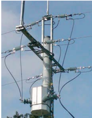
ograniczniki ASI na nowo budowanej linii z rozłącznikiem sterowanym drogą radiową
