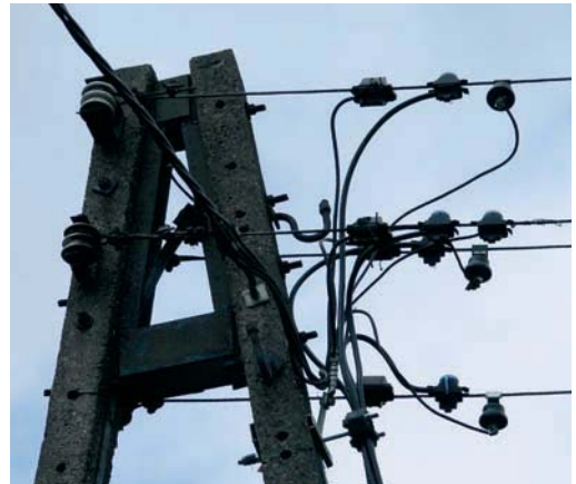
koniec linii napowietrznej nn
