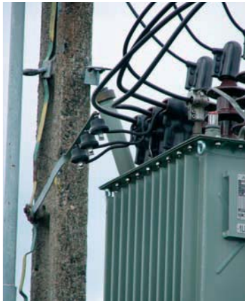
początek linii napowietrznej nn
