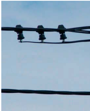
linia główna 1 komplet ASA co 500 m
