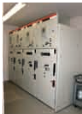
Rozdzielnica 15 kV - typu ZS-8P Switchboard type ZS-8P, 15kV
