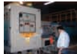
Generalny przegląd wyłącznika typu HE General inspection of Circuit Breaker type HE
