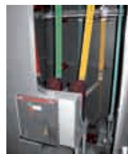
Przykład modernizacji starego pola otwartego z wyłącznikiem małoolejowym na wyłącznik próżniowy typu VD4 Example of modernisation and replacement for old open bay with a low-oil circuit breaker for new vacuum circuit breaker type VD4
