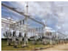
Stacja elektroenergetyczna 220/110 kV „Gdańsk 1” – zastosowanie modułu PASS dla 110 kV 220/110 kV 'Gdańsk 1' Substation – PASS module applications for 110 kV
