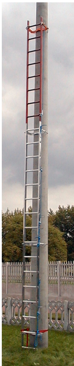
Drabina do słupów (DRS-1, DRN-22) z segmentem izolacyjnym SI-22
