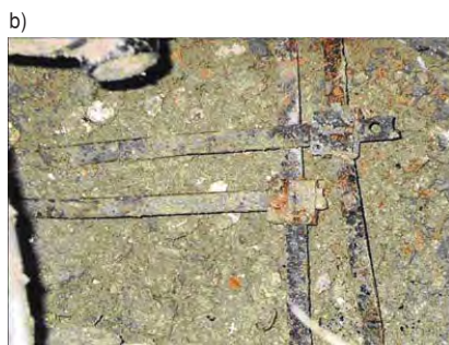
Rys. 10. Korozja bednarki ocynkowanej zastosowanej jako uziom dodatkowy do uziomu fundamentowego
